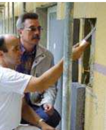
Im Zuge einer Aufdoppelung wird das bestehende Wärmedämm-Verbundsystem zur Beurteilung der Standsicherheit an repräsentativen Stellen geöffnet.
